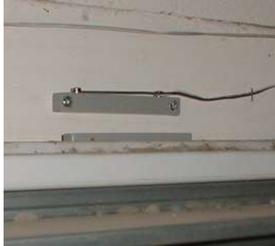
Reed Switch on Garage Door
